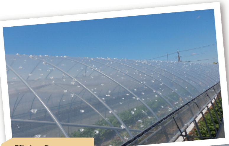
降ひょうによる被害
